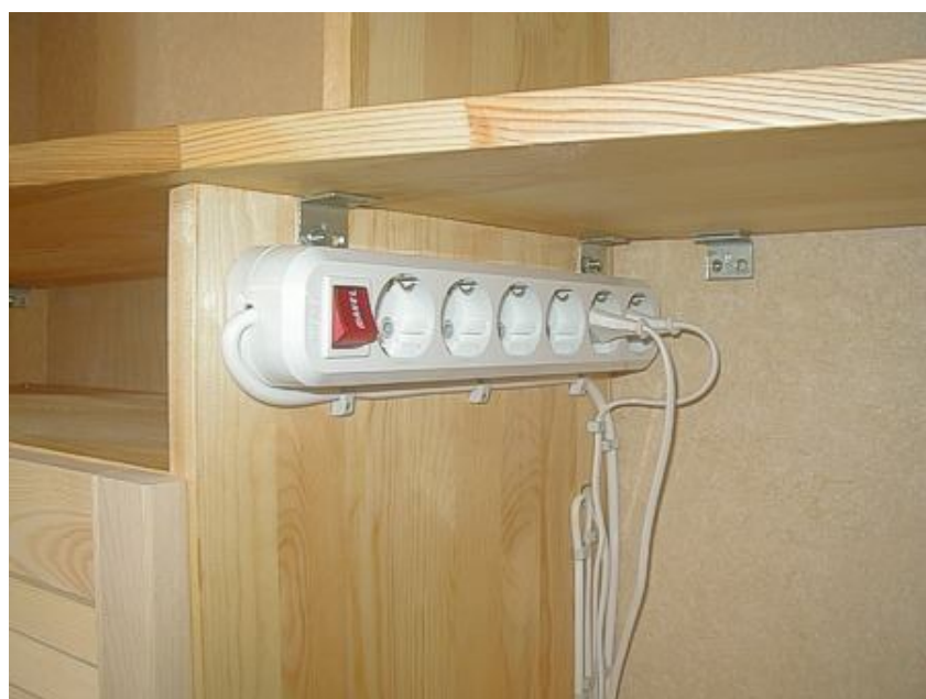
Рис. 17. Крепление блока розеток - так называемого "Пилота".
